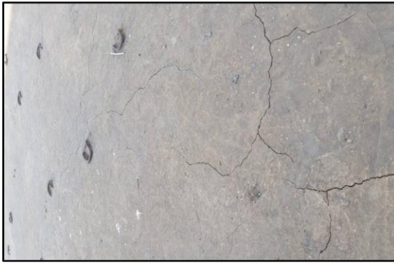
အကျယ် ၂-၄ မီလီမီတာခန့် Crack များ ဖြစ်ပေါ်နေပုံ
